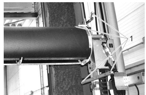
Obr. 9 1 Světelné závory vysokotlaké střešní lišty
